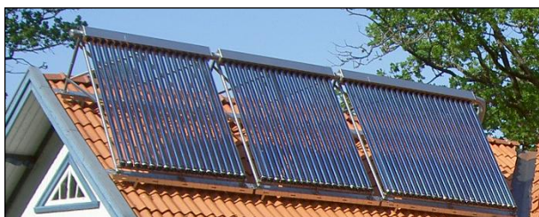
Exempel på uppvinklade solfångare
